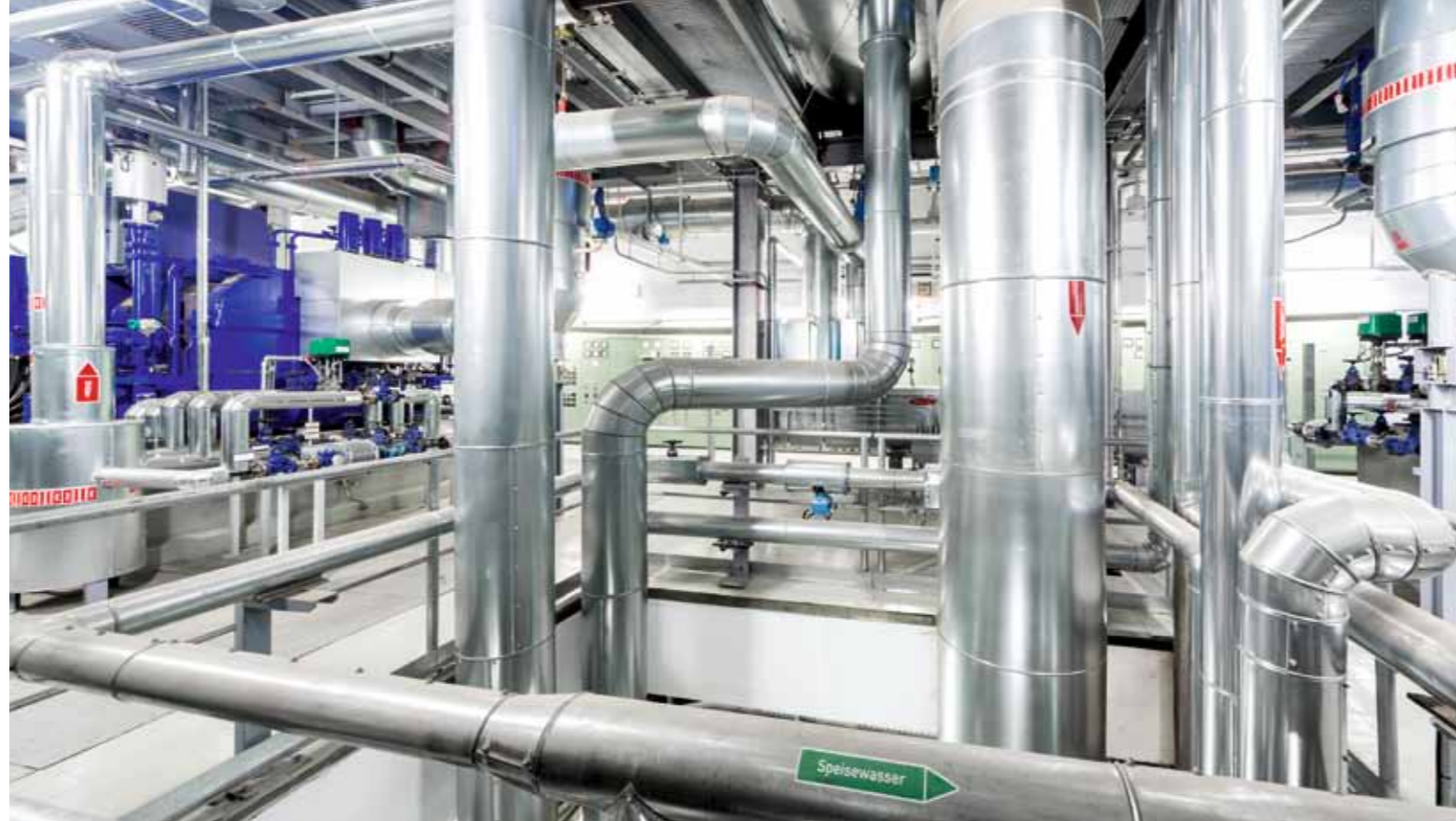
Das neue Heizkraftwerk versorgt die Papierfabrik Julius Schulte zuverlässig mit Dampf und Strom
