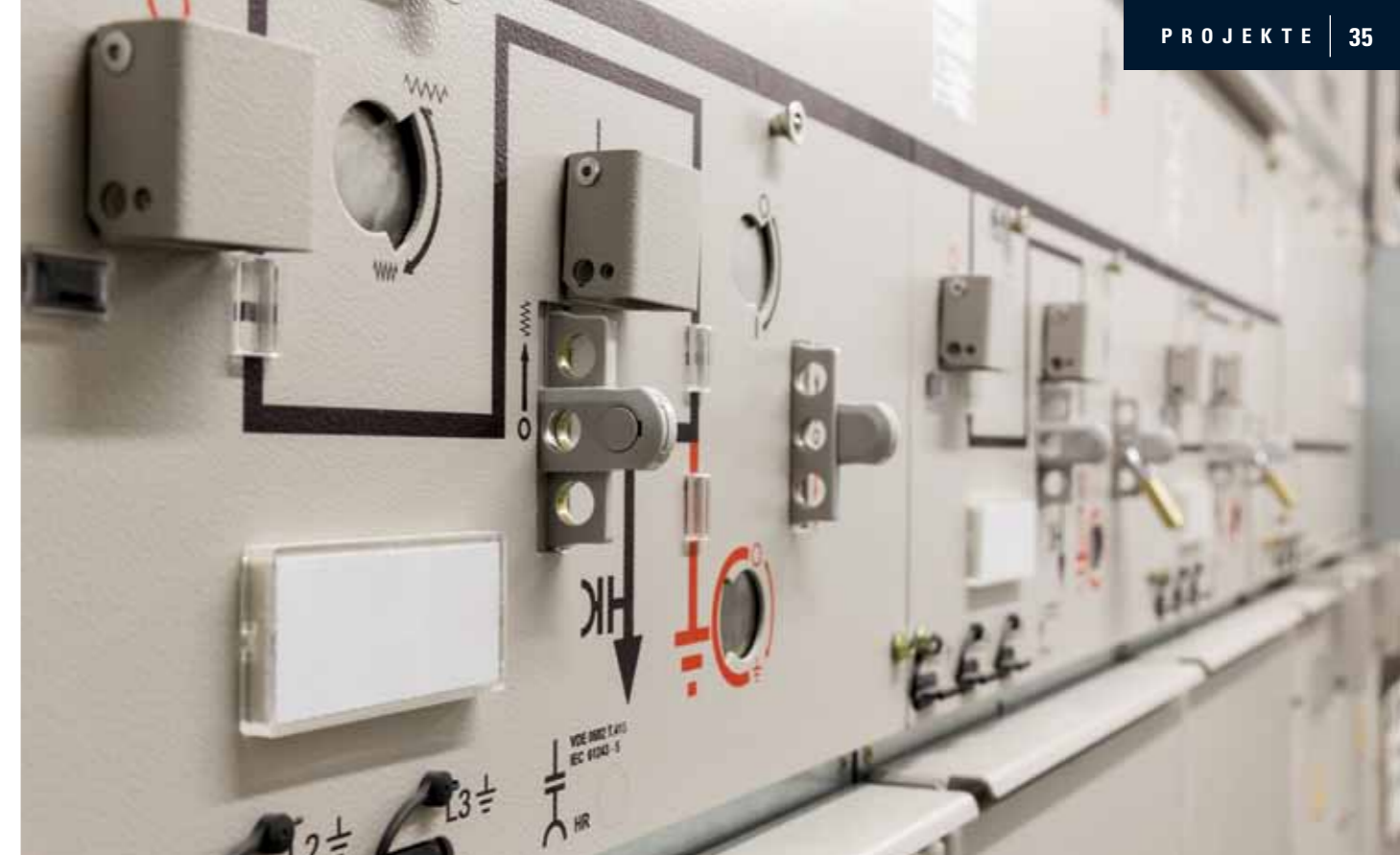
GETEC Arealnetz GmbH, die hundertprozentige Tochtergesellschaft der GETEC net AG, errichtet und betreibt das Arealnetz im MILANEO
